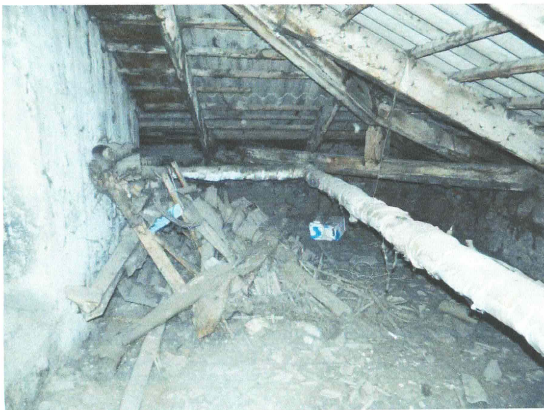
Фото 12. Скопление строительного мусора. Гниение элементов стропильной системы.
