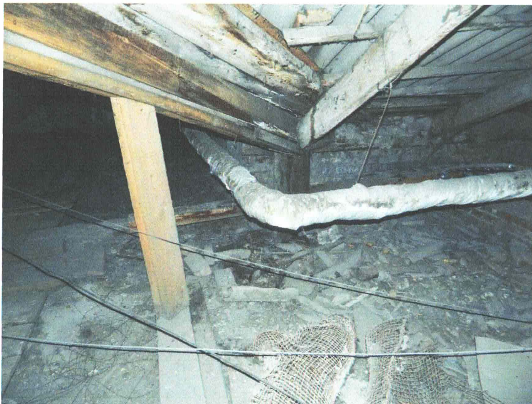
Фото 1. Протечка по ендове на перекрытие лестничной клетки. Скопление строительного мусора.
