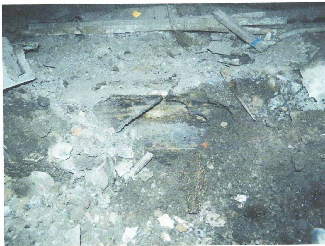
Фото 6. Участок вскрытия балок чердачного перекрытия. Следы замачивания и гниения. Скопление строительного мусора.
