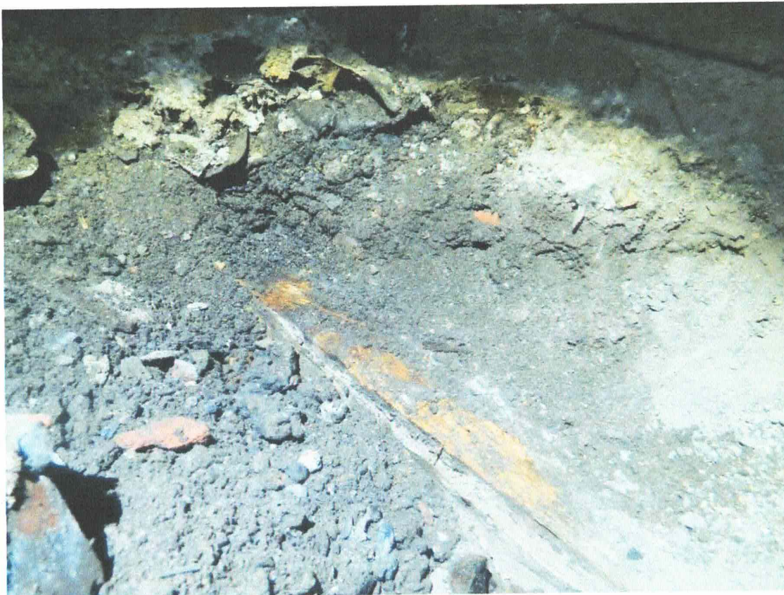
Фото 9. Участок вскрытия балок чердачного перекрытия. Следы замачивания и гниения. На фотографии представлена замененная балка чердачного перекрытия.
