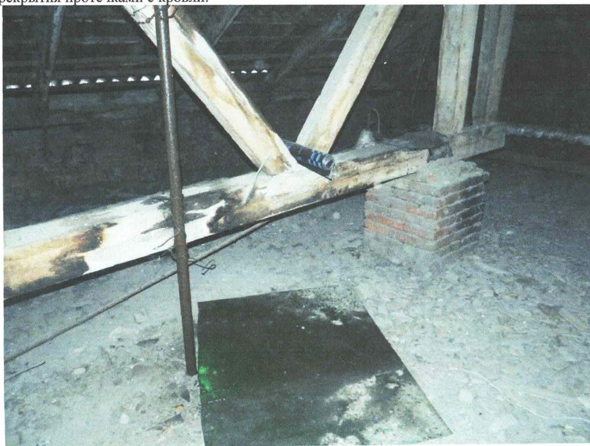
Фото 14. В месте протечки кровли на чердачном перекрытии уложен лист поликарбоната.
