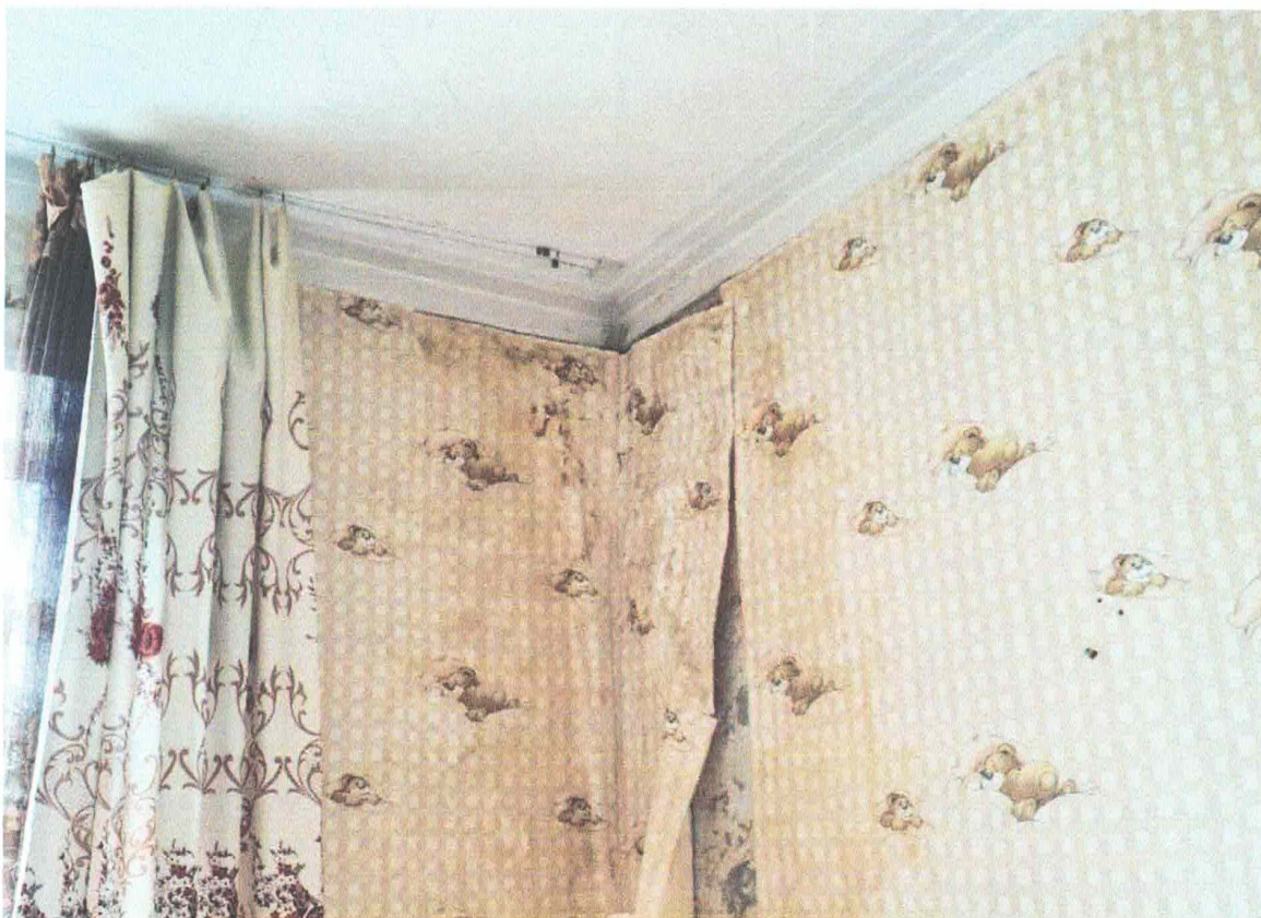
Фото 15. Замачивание с кровли через чердачное перекрытие квартиры №11.
