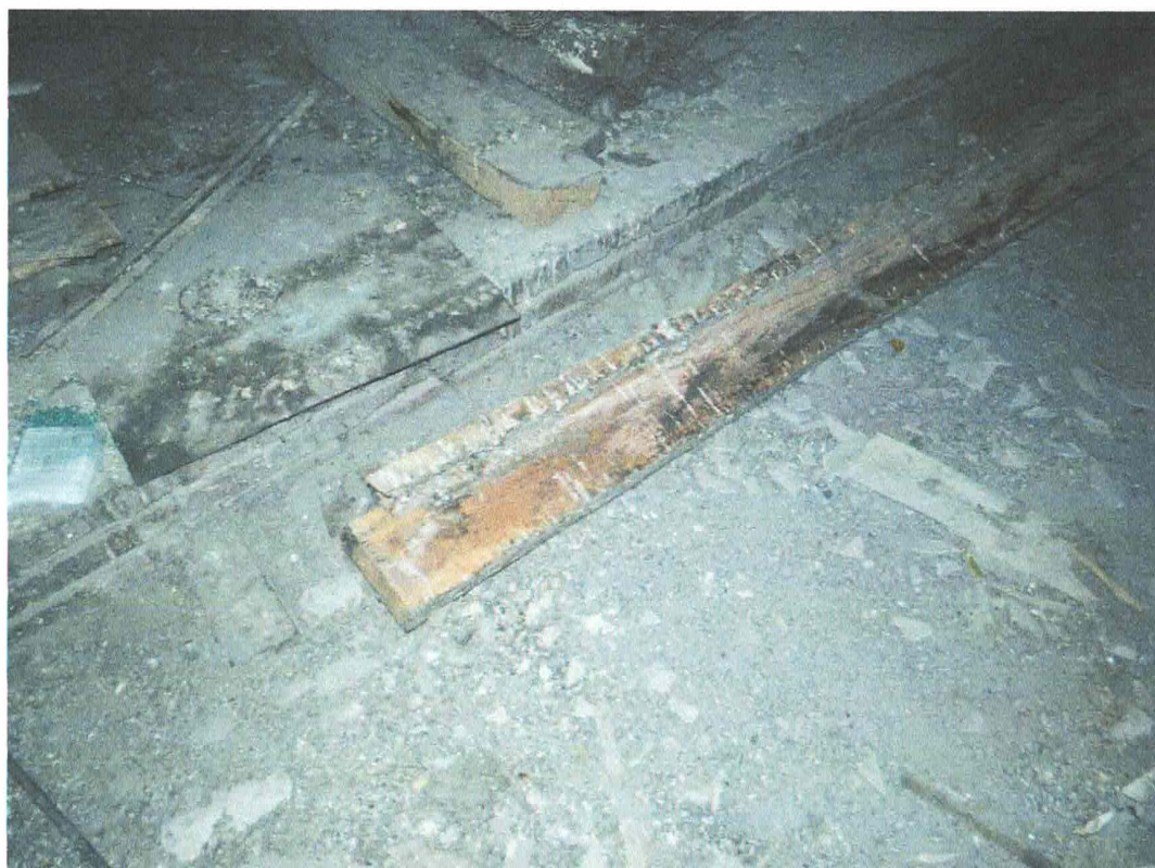
Фото 2. Скопление строительного мусора после частично выполненного ремонта балок чердачного перекрытия.
