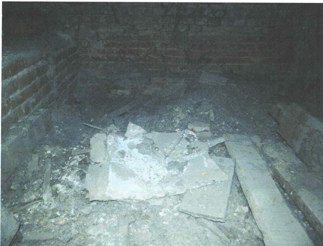
Фото 3. Следы ремонтно-восстановительных работ балок чердачного перекрытия. Скопление строительного мусора.
