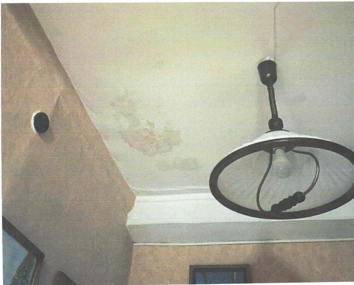
Фото 17. Протечки через чердачное перекрытие, квартира №32.
