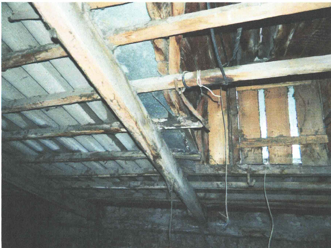
Фото 4. Неплотности элементов узла слухового окна, протечки на чердачное перекрытие..
