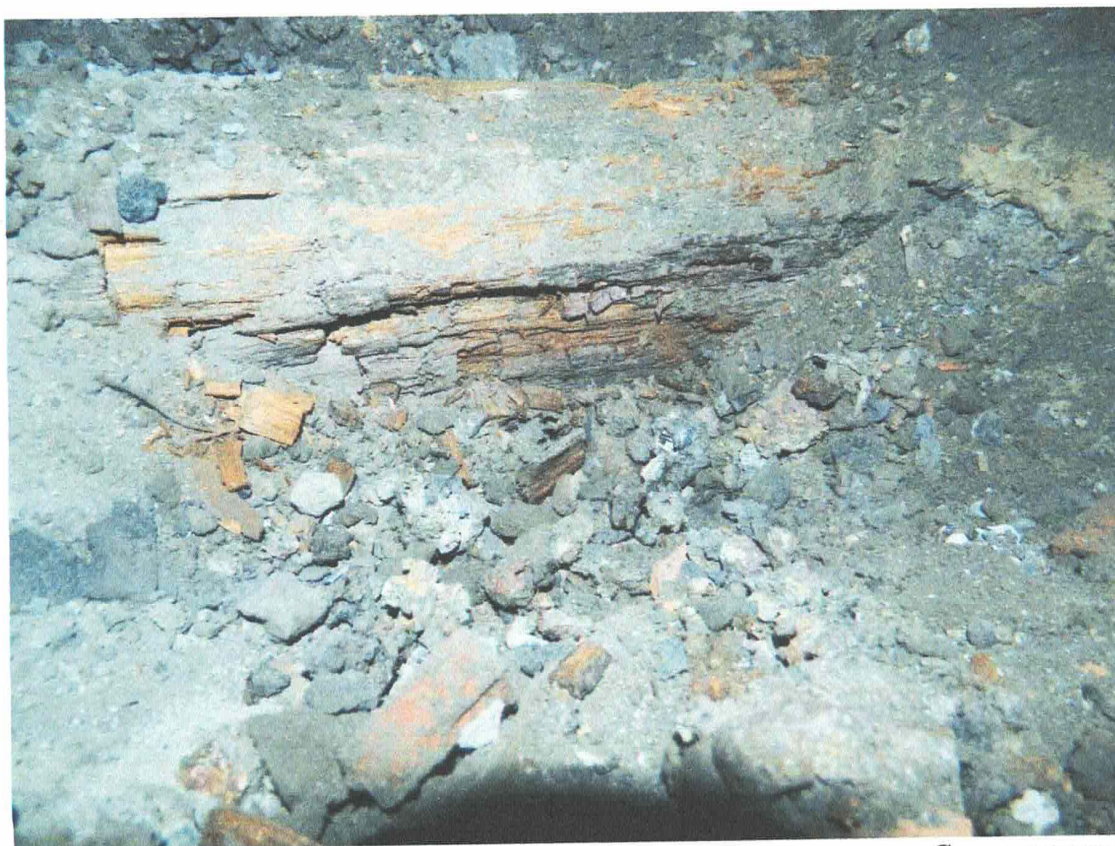
Фото 10. Участок вскрытия балок чердачного перекрытия над санузлом. Следы замачивания и гниения.
