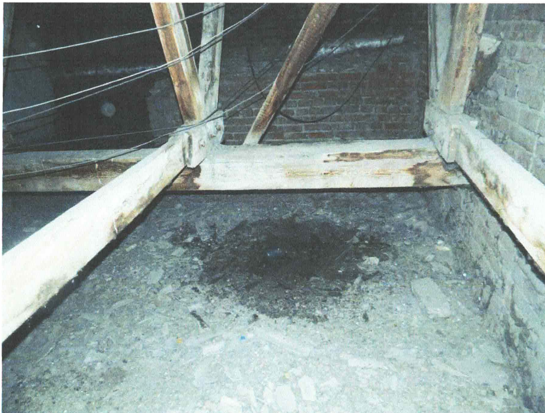
Фото 13. Участок интенсивного замачивания теплоизоляционного слоя и балок чердачного перекрытия протечками с кровли.
