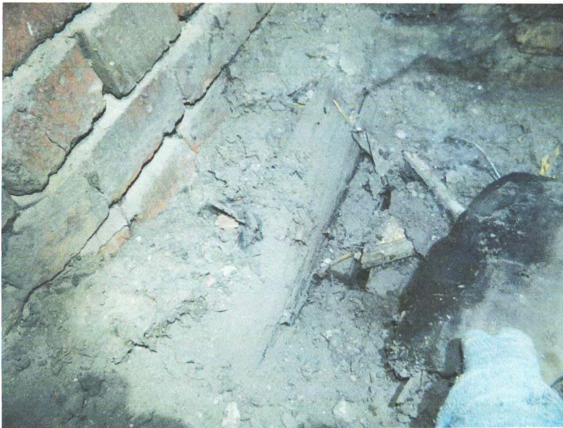
Фото 5. Следы замачивания и гниения балок чердачного перекрытия. Просыпание теплоизоляционного слоя чердачного перекрытия в щели деревянного щита перекрытия.
