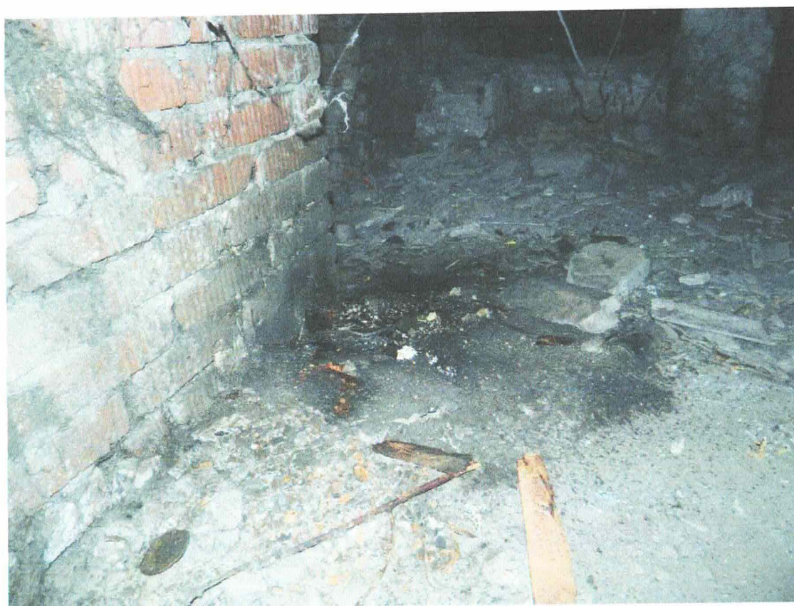
Фото 8. Обильное замачивание участка балок чердачного перекрытия протечками с кровли.
