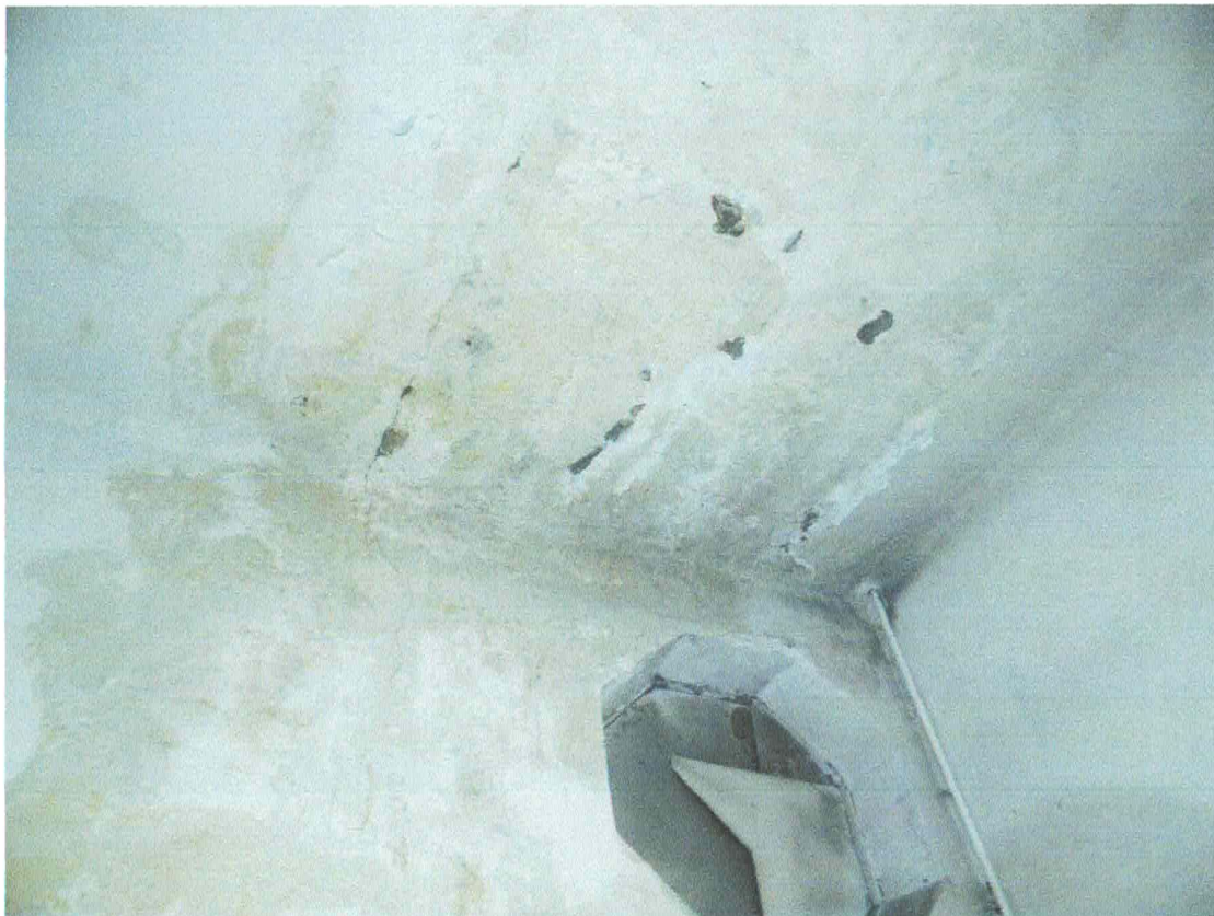
Фото 11. Следы замачивания в подьезде. Образование грибка.
